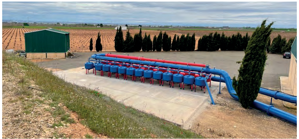
Cadena de filtros de arena para agua depurada antes de su salida a la red de riego, en las instalaciones de la comunidad de regantes Los Auriles (Tomelloso, Ciudad Real).
